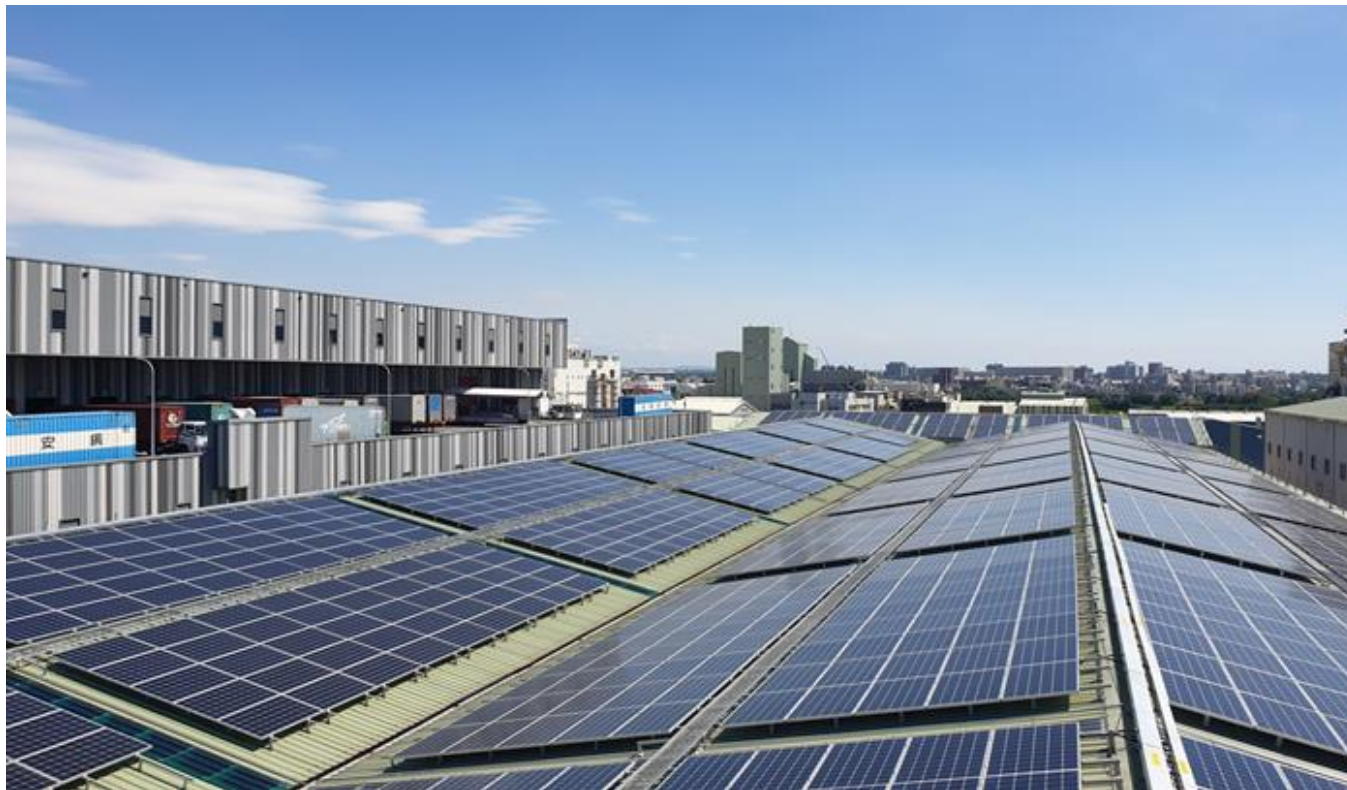
大園廠廠房屋頂太陽能板
