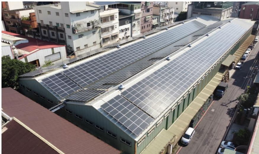
新莊廠廠房屋頂太陽能板
