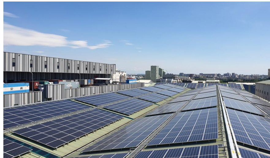
大園廠廠房屋頂太陽能板
